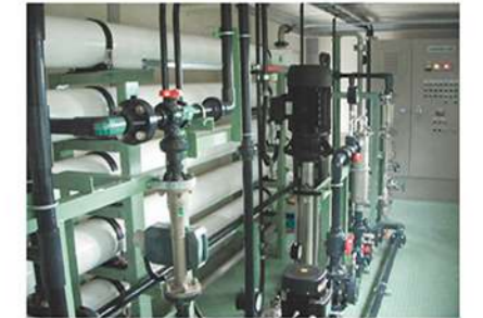
脱塩濃縮装置
