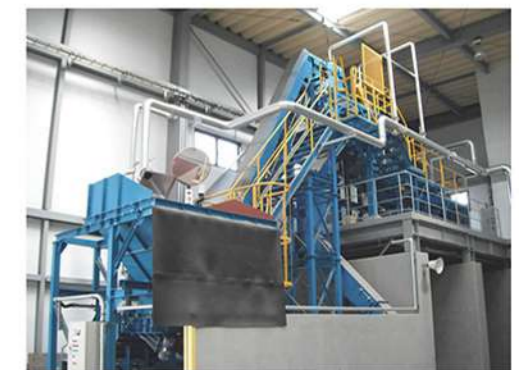
風力選別機設備
