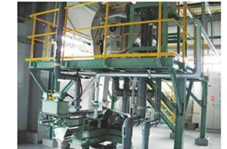
し渣スクリーン・し渣脱水機
